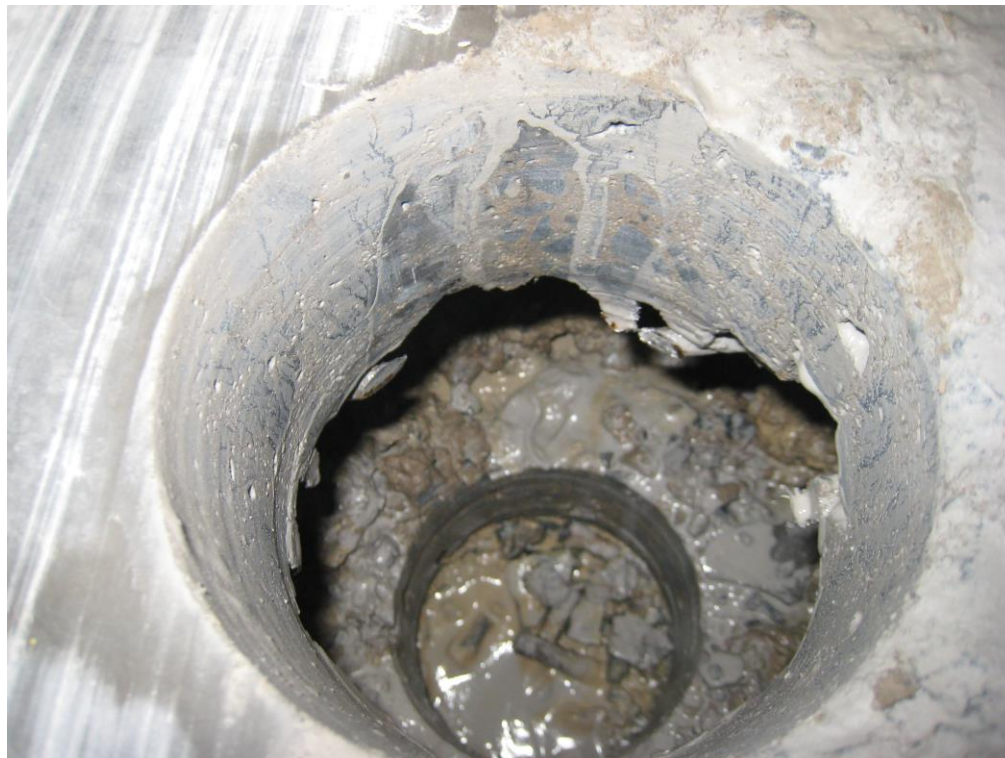
Figura 04 – Vazio no piso
