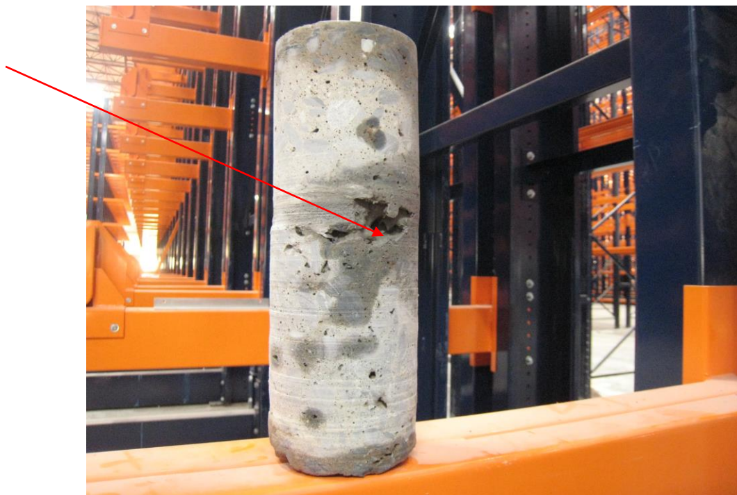
Figura 06 – Porosidade no piso
